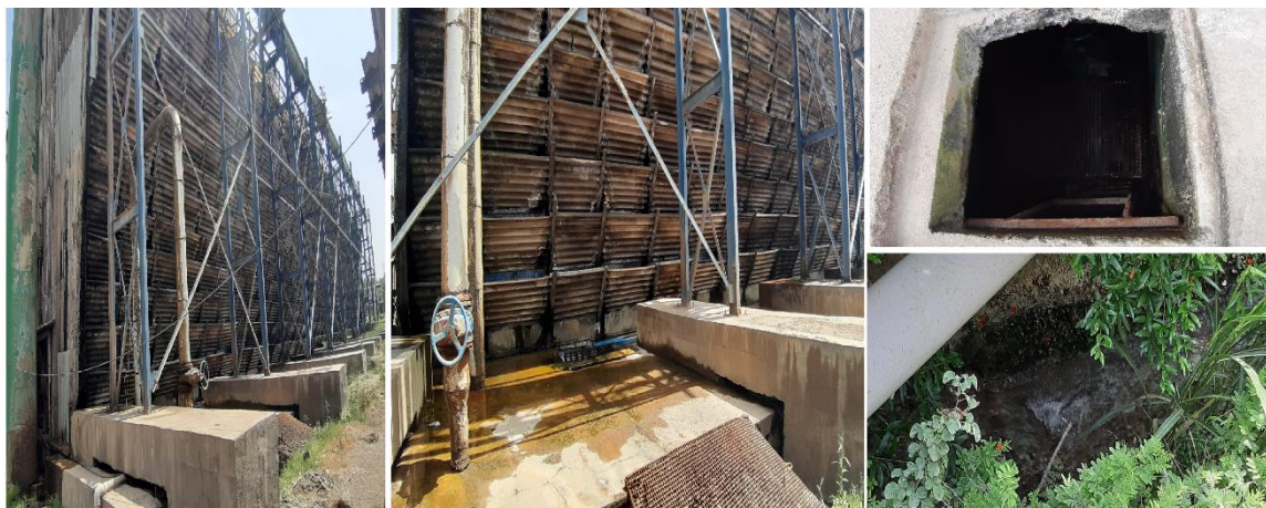
Fig. 6. The picture of the cooling tower of the cross flow and the exit path of blow down شکل ۶- تصویر برج خنک کننده تر جریان متقاطع و مسیر بلودان خروجی
