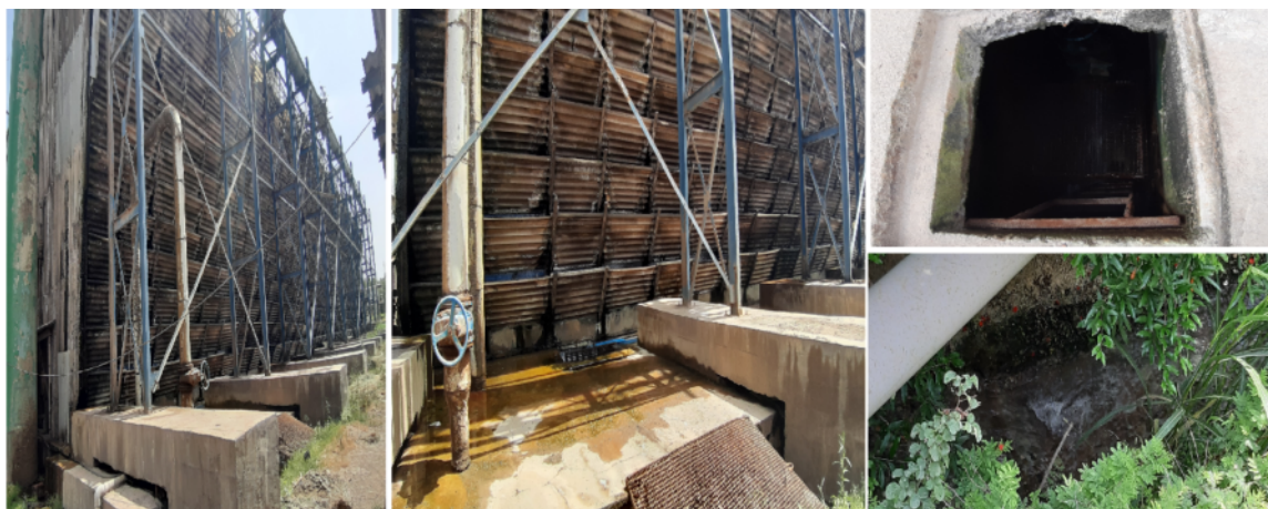
Fig. 6. The picture of the cooling tower of the cross flow and the exit path of blow down شکل ۶- تصویر برج خنک کننده تر جریان متقاطع و مسیر بلودان خروجی
