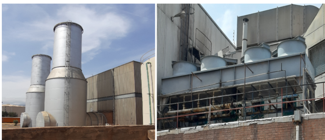
Fig. 7. Image of gas units and oil cooling system شکل ۷- تصویر واحدهای گازی و سیستم خنک کننده روغن
