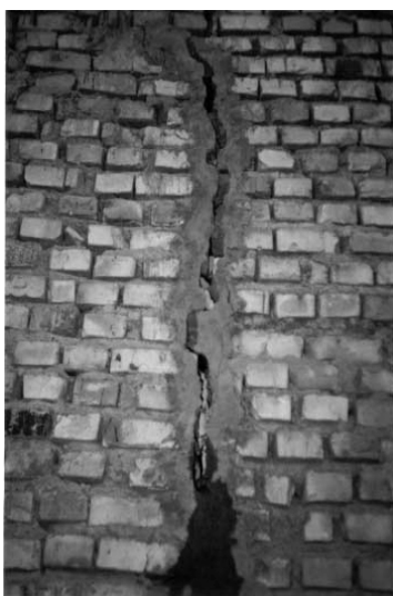
شکل ۵- ایجاد شکاف در منازل مسکونی به علت فرایند نشست زمین
