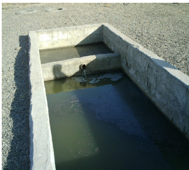
شکل ۱- هاضم بی‌هوای در ورودی و برکه بی‌هوای در ادامه
