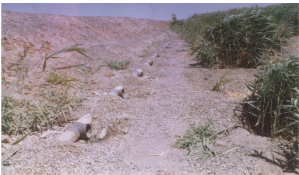
شکل ۴- لوله‌های توزیع فاضلاب ورودی به بستر نیزار زیرسطحی
