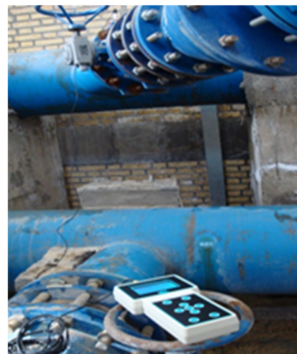
Fig. 7. Data logger & pressure sensor in Piranshahr شکل ۷- ثبت کننده داده‌ها و سنسور فشار پیرانشهر
